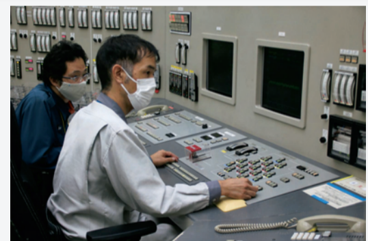
運転再開時の中央制御室の様子
